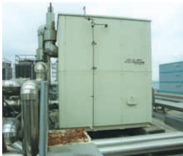
ノンフロン冷却設備
