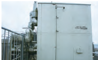
ノンフロン冷却設備
