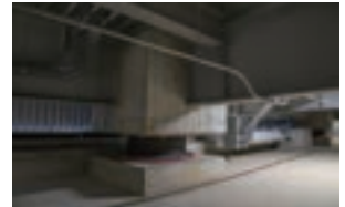
災害に強いエコ倉庫 免震装置 (神戸・西神配送センター)
